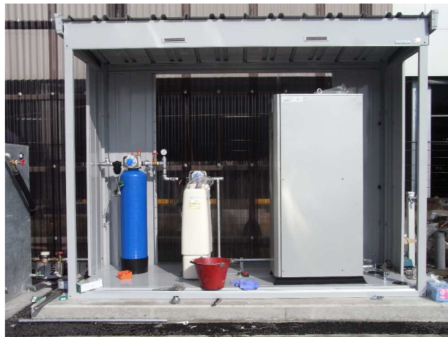
逆浸透膜法による RO 水発生装置
